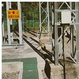
発電所・変電所
